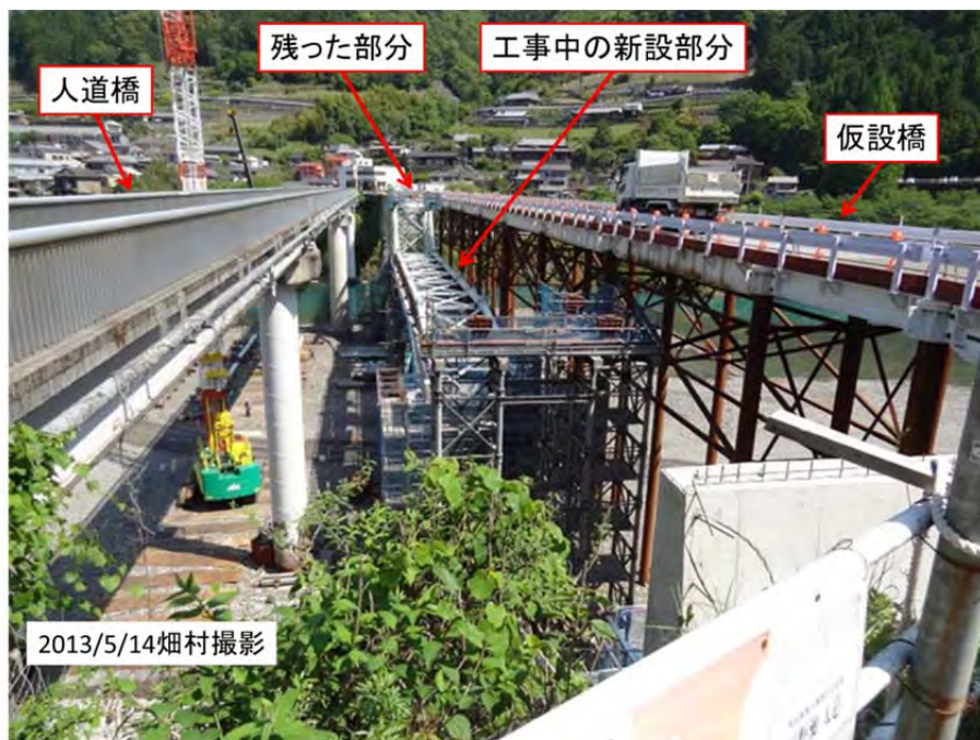
図12 落橋した折立橋（おりたちばし、十津川村）の復旧工事現場
