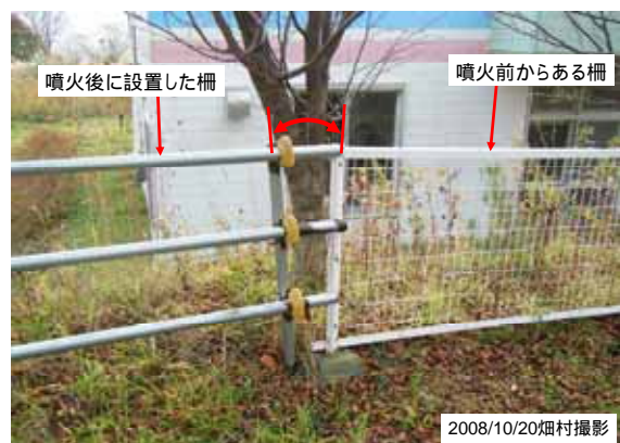
写真8 洞爺湖幼稚園の裏の旧国道での柵。 右が噴火前、左が噴火後。縦の柱の開き方で 地表の傾きの変化がわかる。約1/10位に見えた。
