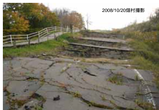
写真10 町道泉公園線 (写真向うが隆起し、手前がずれ落ちたので、道が階段状になった。)
