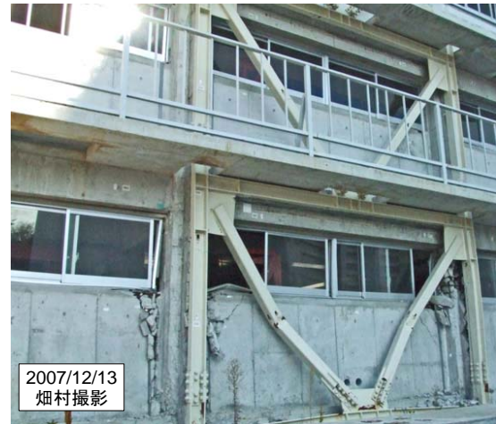
写真 14 地震動の力で座屈した筋交い (筋交いが突っ張るので建物が致命的な破壊に至らない)
