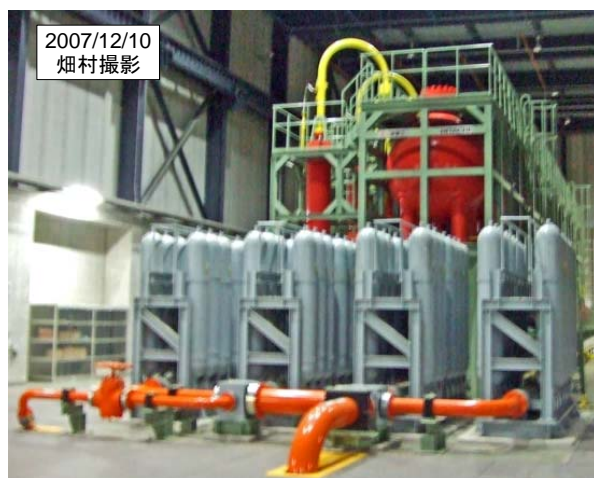
2007/12/10 畑村撮影 写真3 制御用油圧系統に用いられているアキュムレータ(蓄圧器) (N 2 ガスポンプ(灰色)と油タンク(橙色))
