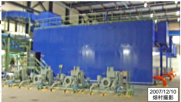
2007/12/10 畑村撮影 写真2 動力源のLNG使用のガスエンジン(青いカバーの中にある) (これで直接に斜板形レシプロポンプを駆動している)
