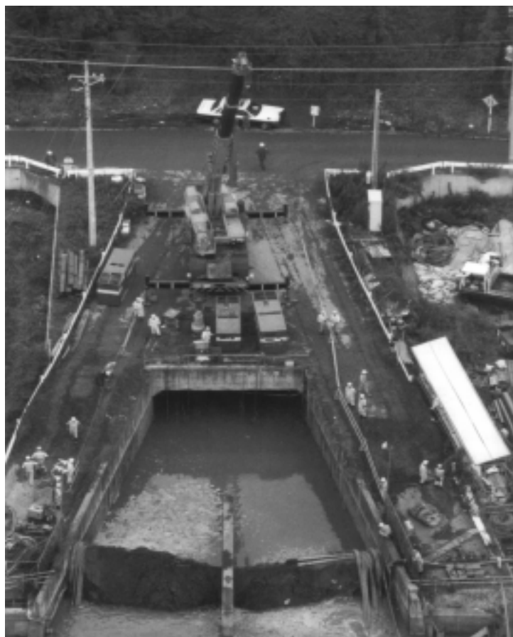
図 2 . 事故翌日(1991 年 9 月 20 日)の現場状況 (「建設事故」(日経 BP)より)
